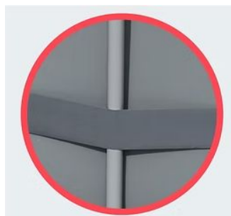
Photo 2 : NOK , sangle de compression à l'extérieur des poteaux de support de la piscine
