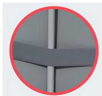
Photo 2 : NOK , compressieband aan de buitenkant van de steunpalen van het zwembad
